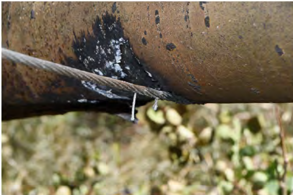
Melting of conductors (JMD_4251)
